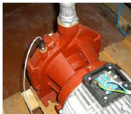
Obr. 3: Příklad nalévacího otvoru výtlaku čerpadla s namontovaným tlakovým čidlem
